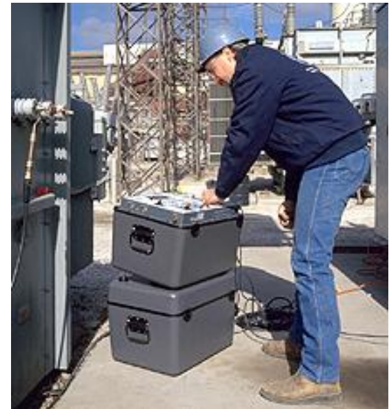
Prueba de Factor de Potencia (Fuente: Megger)
