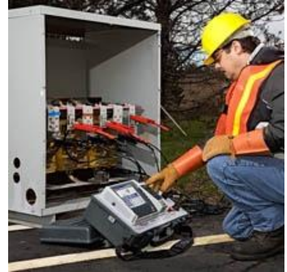
Prueba TTR en Transformador (Fuente: Megger)
