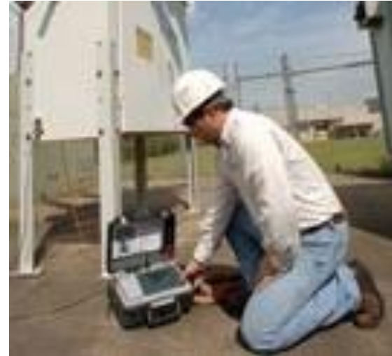
Prueba de Resistencia de Aislamiento (Fuente: Megger)
